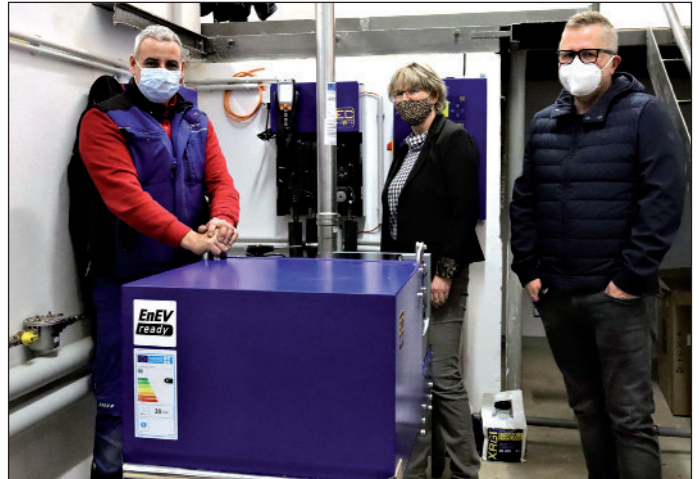
Archivfoto von der Inbetriebnahme des Blockheizkraftwerkes im Julius-Motteler-Gymnasium. Robby Lehmann (Firma Oswald Meister), Katrin Penzel (amt. Schulleiterin), Uwe Baldzun (Ingenieurbüro BBS GmbH) v.l.n.r.
